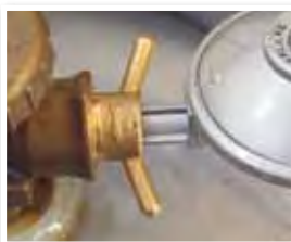
T.v. Gasolbehållare med monterad reducerventil
